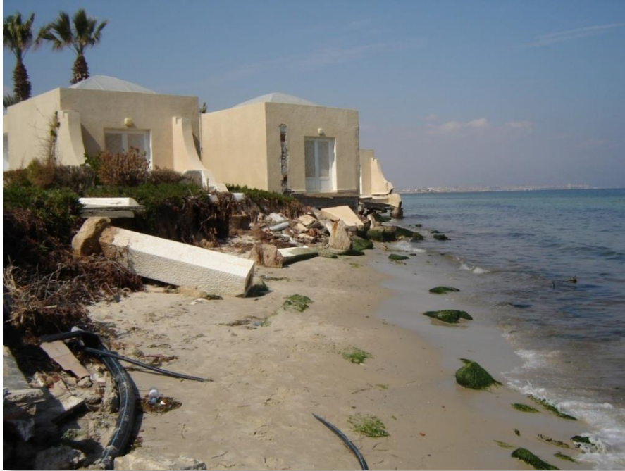
Figure 8: Erosion affectant des bungalows d'une unité touristique à Dkhila (la situation en 2009) (photo, F. Brahim).
