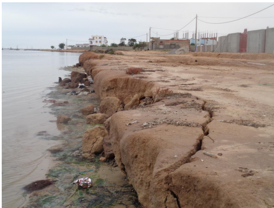
Figure 16: Petite falaise développée dans des dépôts continentaux rougeâtres, fortement affectée par l'érosion à Ellouza (photo, F. Brahim).
