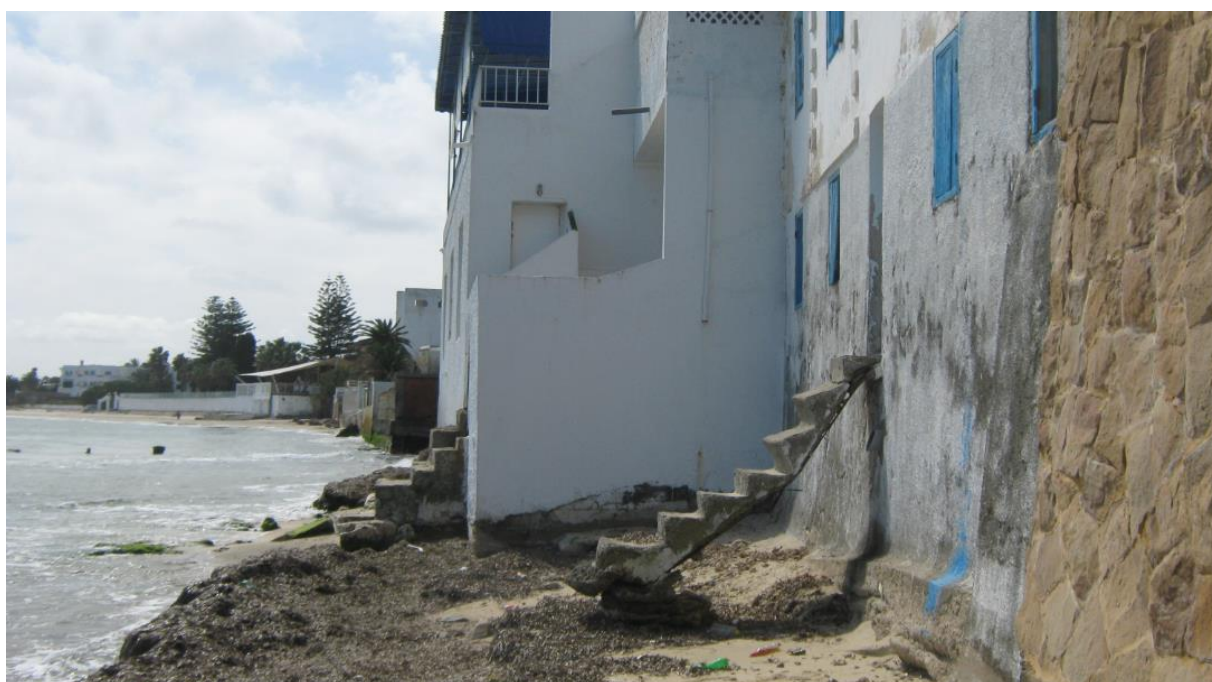
Figure 38: Exemple d'érosion avancée avec disparition totale de la plage et menace sur les constructions de front de mer (côte de Bizerte) (photo A. Oueslati).
